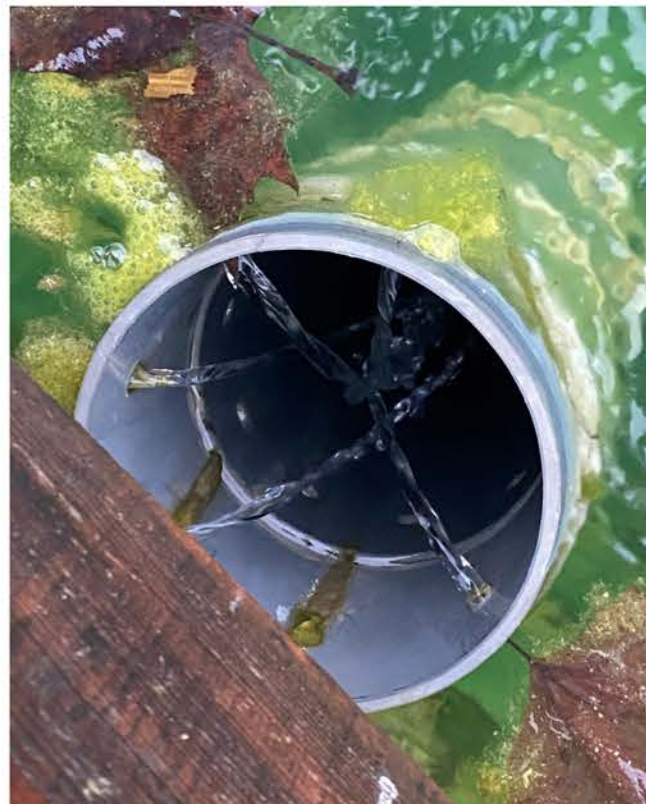
BUSE DE TROP PLEIN
